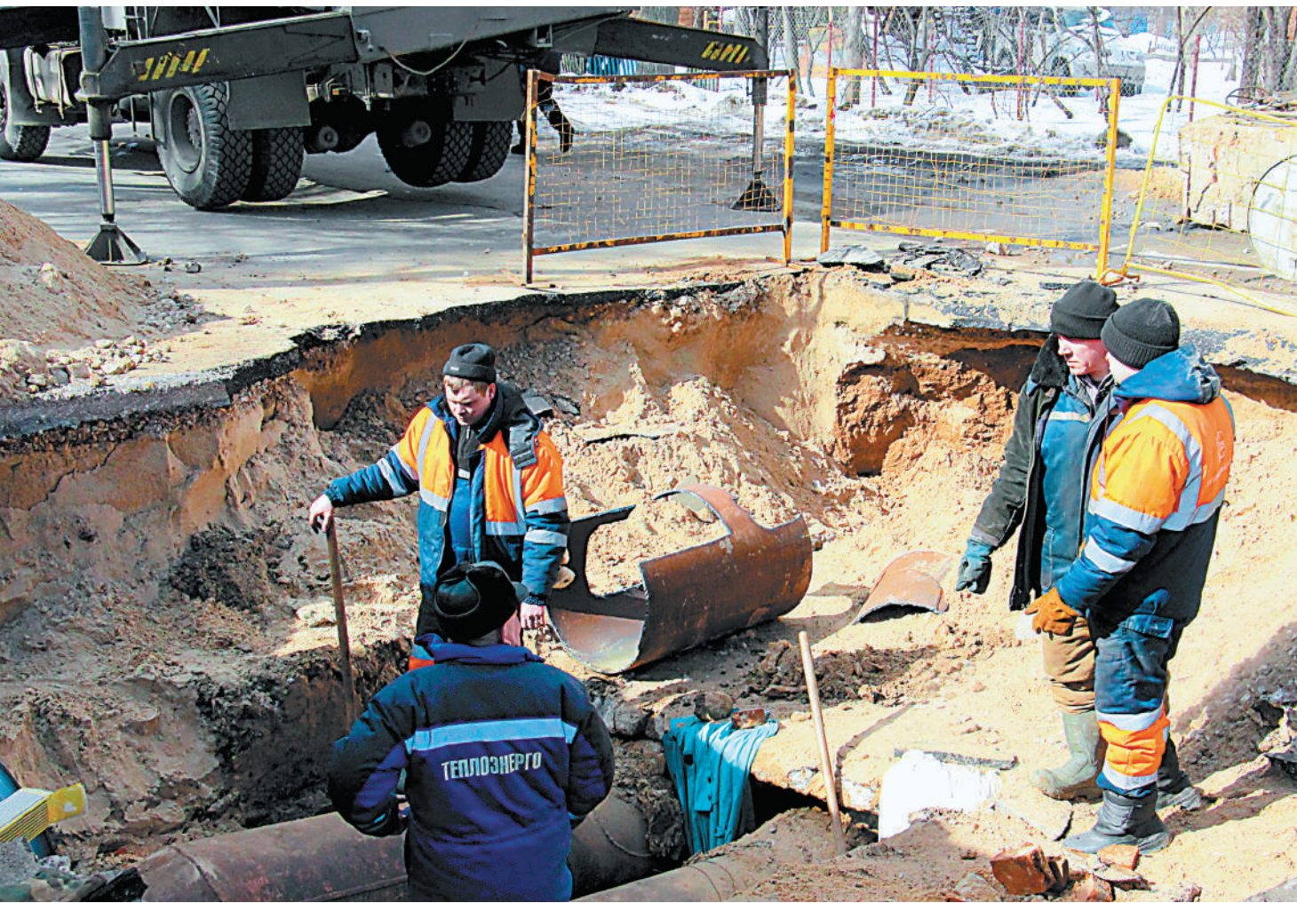
Поврежденный участок магистрального трубопровода на улице Невзоровых заменят уже в этом году.
